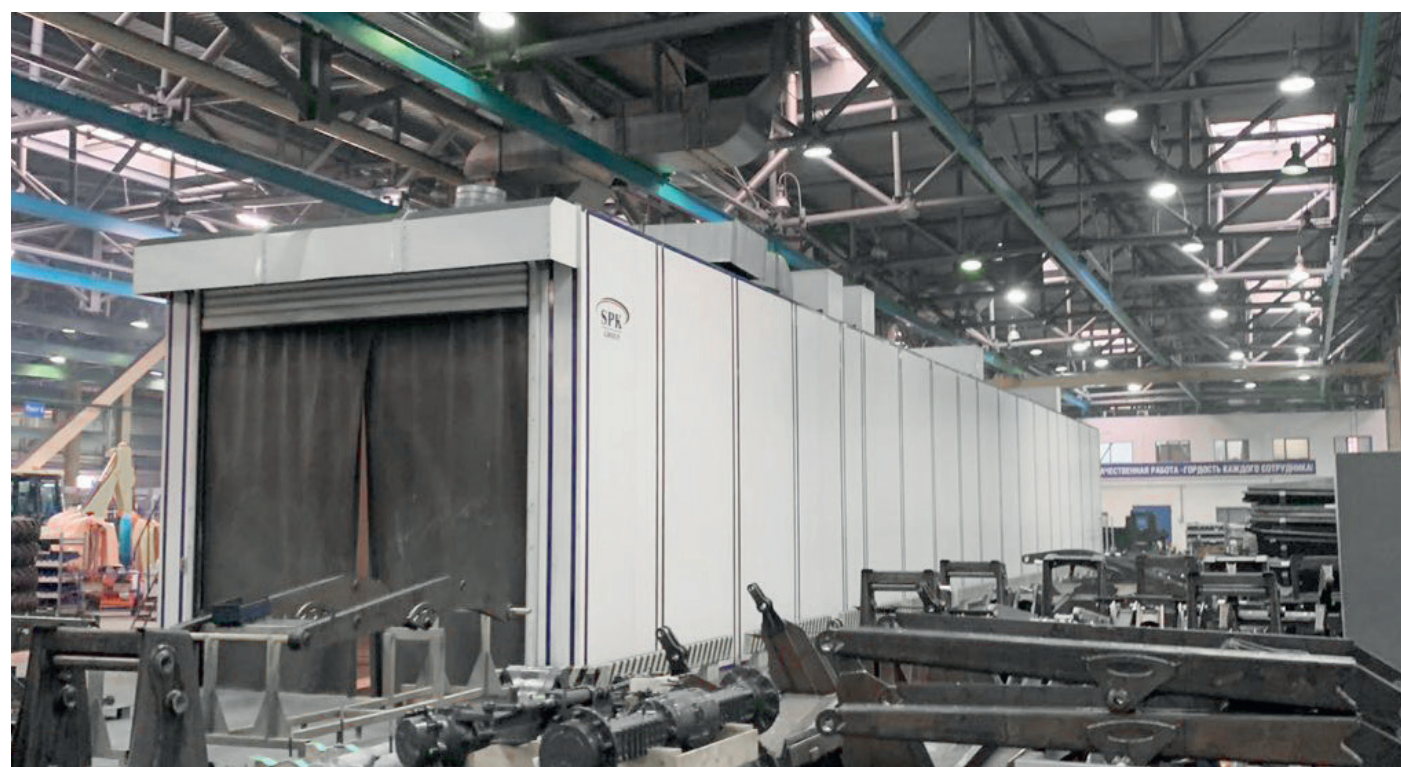
Дробеструйная камера в составе комплекса подготовки и покраски для дорожно-строительной техники SPK-34.5.4, «ПО ЕлАЗ», г. Елабуга
